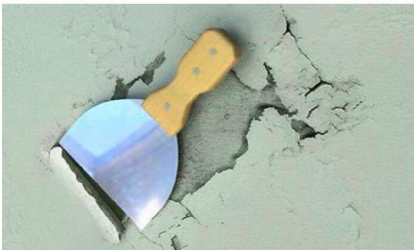
Рис. 2. Отслаивающаяся вместе со шпатлевкой водоземulsionная краска
